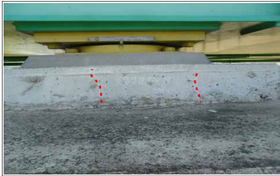
상행선 P14 SH4 받침콘크리트 균열 (폭0.1mm)
