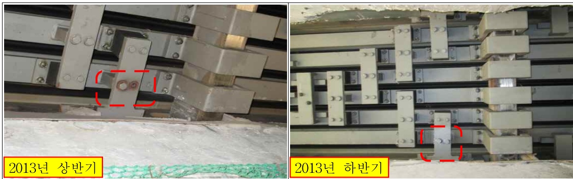
하행선 P15 신축이음 하부 본체 하부 간격조절재 볼트 탈락 보수 전·후 현황
