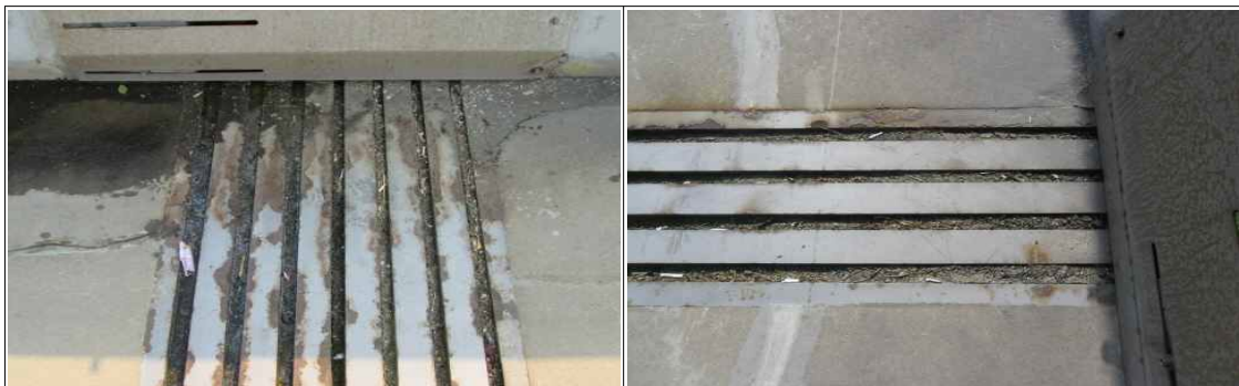
상행선 P15 신축이음 본체 이물질 퇴적, 녹발생 및 체수
