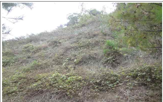
사면(중점부) STA.0+10 1단 표층유실
