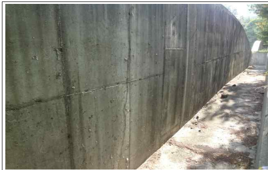
사면(시점부) STA.0+20 갯문 배면 균열
