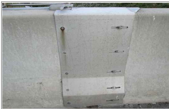
상행선 P2 차수판 앵커볼트 탈락
