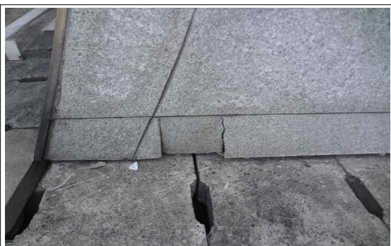
하행선 갭문 종점부 파손
