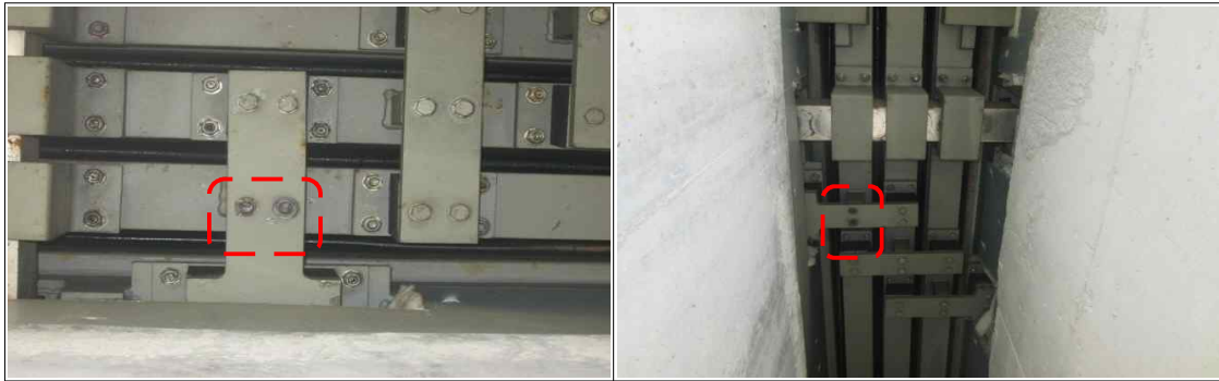
상행선 A2 신축이음 본체 하부 간격조절재 볼트 파단
