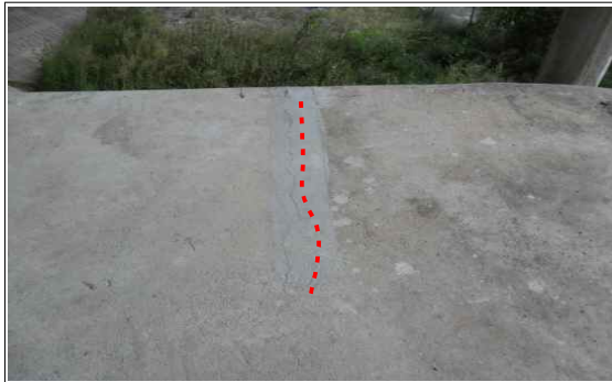
상행선 A1 상면 보수부 재균열 (폭0.2mm)
