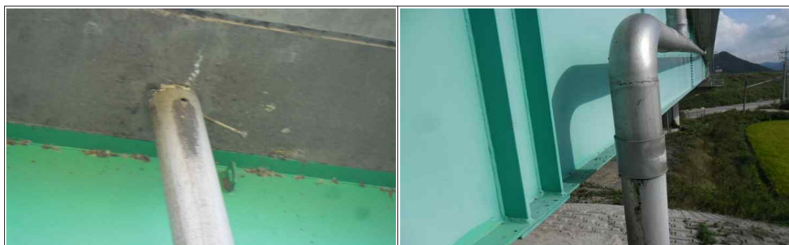
상행선 S5 배수관 연결핀(고정볼트) 탈락
