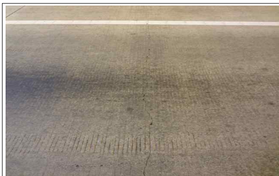
하행선 포장부 S82 균열
