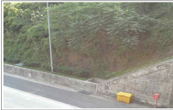
사면(시점부) STA.23+60 1단 녹생토유실
