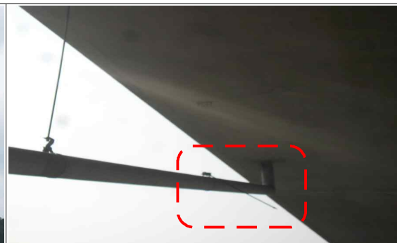
상행선 S22 배수관 연결재 탈락
