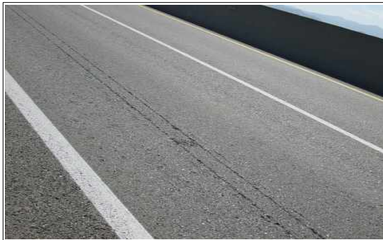
상행선 S13 교면포장 패임
