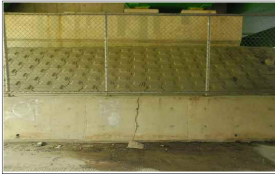
상행선 A1측 L형 옹벽 수직균열 및 단차발생(보수미흡)
