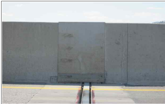
상행선 A2 차수판 볼트 탈락
