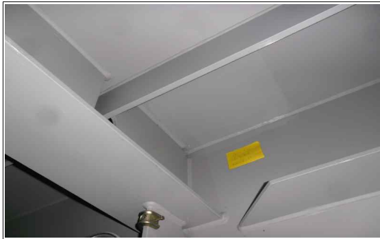
상행선 S7 G1 주형내부 기존 도장손상 보수현황
