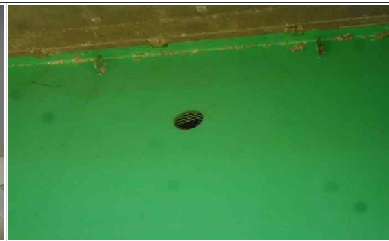
하행선 S9 G2 주형내부 환기망 파손
