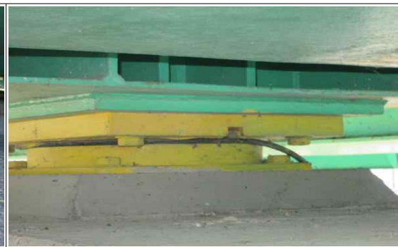
하행선 P10 SH8 Seal재 파손
