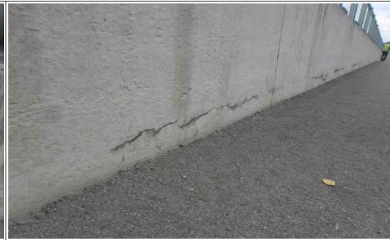
상행선 S2 방호벽 균열 (폭0.1~0.2mm)
