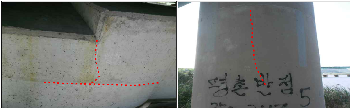
상행선 P1 코핑 배면 균열 (폭0.1mm)
