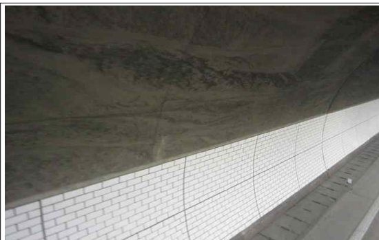
상행선 측벽부 S68 균열 (폭 0.2mm)
