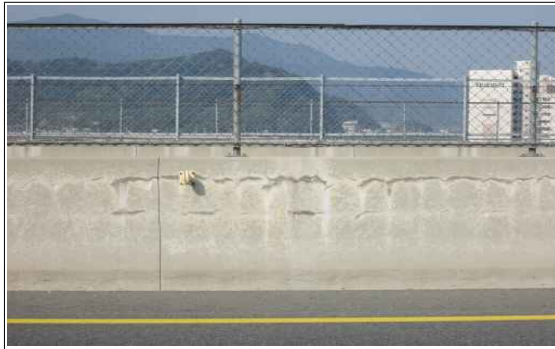
상행선 S17 방호벽 균열부 백태
