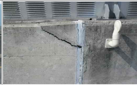
하행선 A1측 접속도로 구간 방호벽 콘크리트 파손
