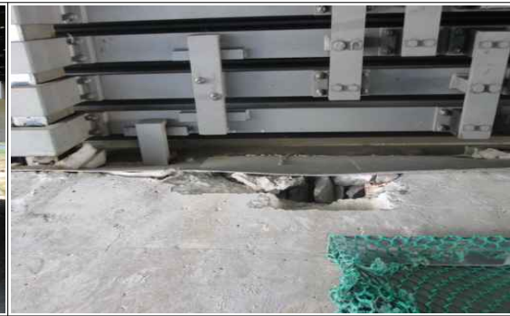
하행선 S16 주형외부 상부슬래브 지점부 콘크리트 파손
