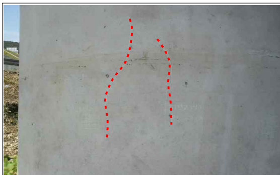
상행선 P1 기둥 정면 균열 (폭0.1mm)
