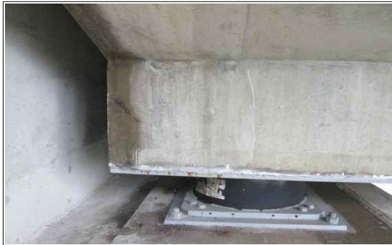
하행선 S25 주형외부 좌측면 반침부 수직균열(폭0.2mm)
