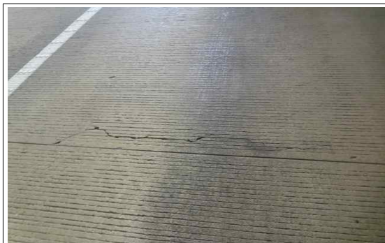
하행선 포장부 S24 파손
