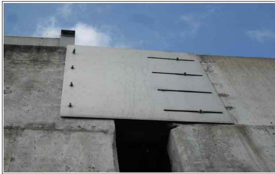
상행선 A1 차수판 볼트 탈락
