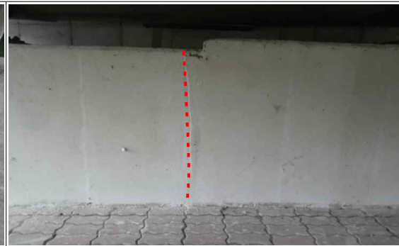
상행선 A1 상면 보수부 재균열 (폭0.2mm)
