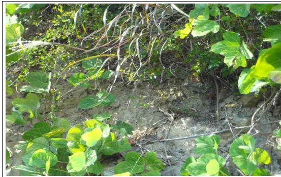
사면(시점부) STA.0+0 자연사면 표층유실 및 이완암
