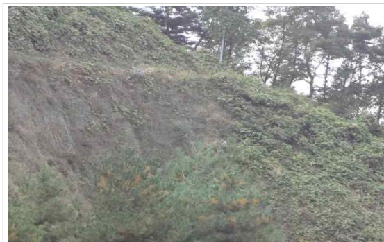
사면(시점부) STA.23+810 1단 녹생토유실
