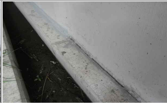
상행선 A2측 배수로 균열 및 이격 발생
