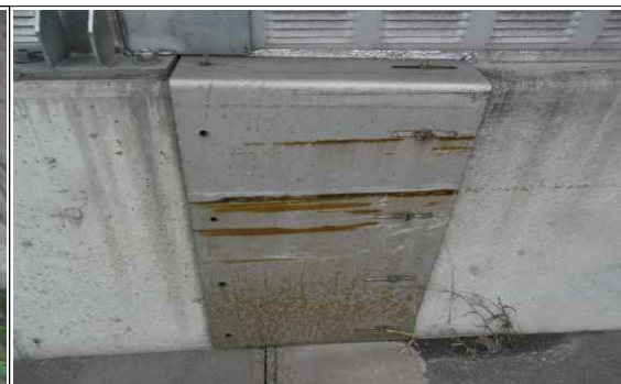
하행선 A1 차수관 앵커볼트 탈락
