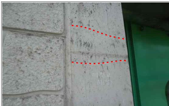
상행선 A1 날개벽 균열 (폭0.1mm)
