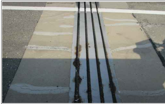
상행선 A1 신축이음 후타재 보수부 재균열
