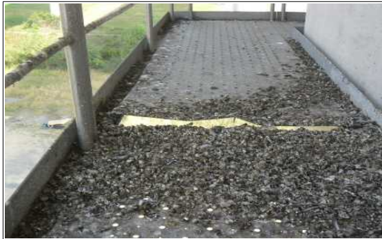
상행선 P15 점검로 발판 탈락 및 이물질 퇴적
