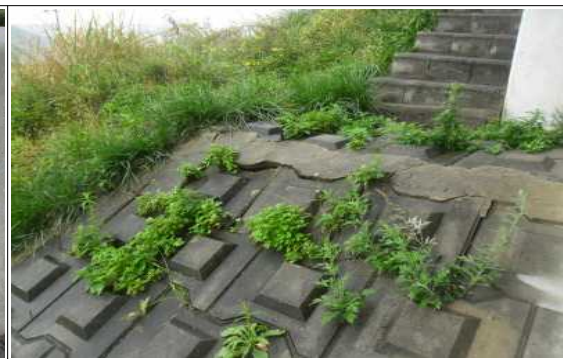
하행선 A2 법면 침하 및 공동
