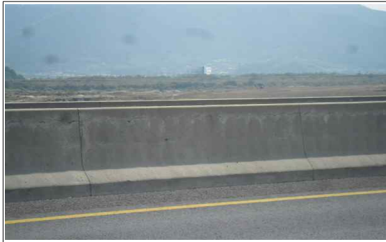
하행선 S3 방호벽 균열부 백태
