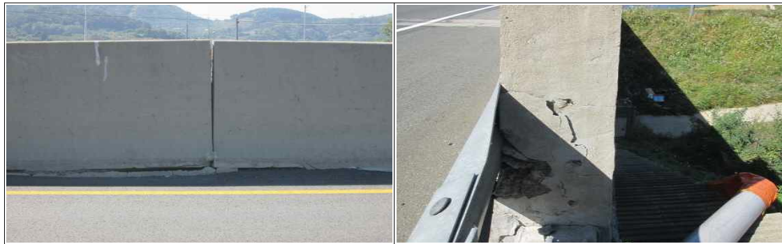
상행선 교량진입부 중분대 침하(기존 결과와 비교시 진전없음)
