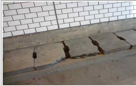
상행선 공동구 S2 덮개파손
