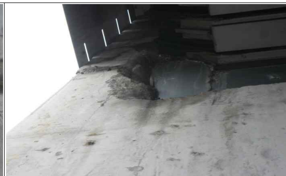
상행선 A2 홍벽 콘크리트 파손
