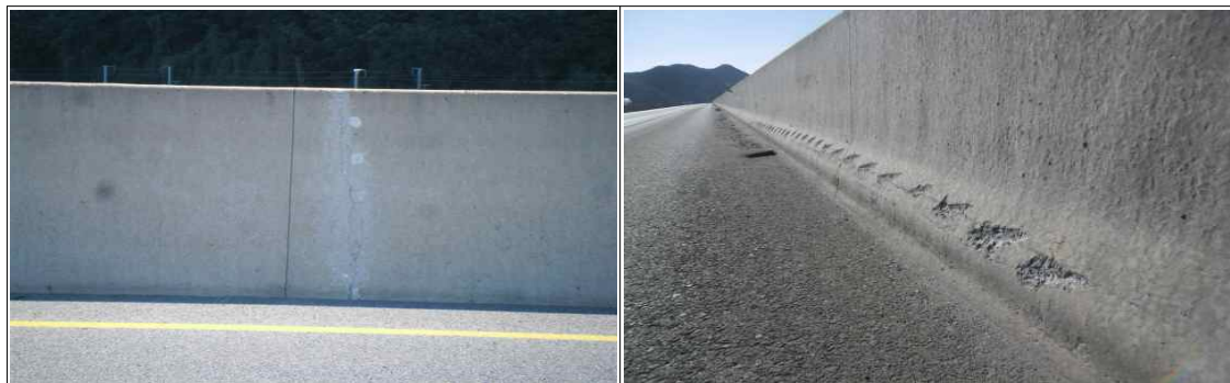
하행선 S7 방호벽 보수부 재균열
