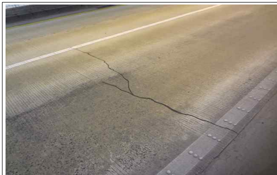
상행선 포장부 S24 균열
