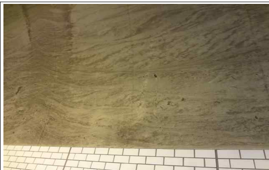
하행선 측벽부 S70 균열 (폭 0.3mm)
