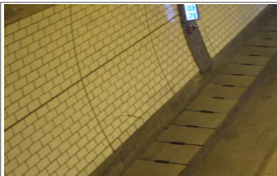
상행선 측벽부 S6 타일 파손
