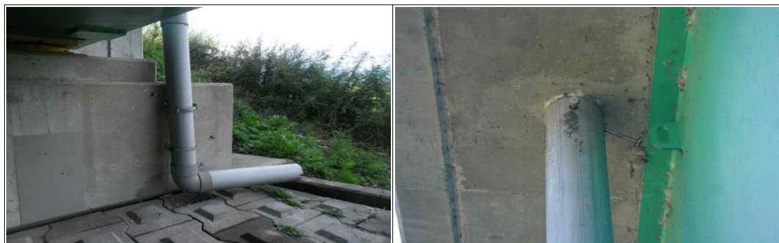
상행선 A2측 배수관 연결고리 탈락
