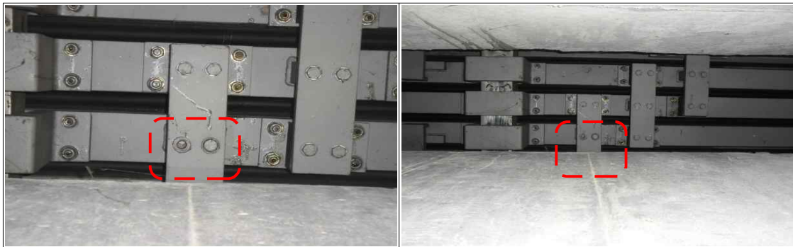
하행선 A1 신축이음 본체 하부 간격조절재 볼트 탈락
