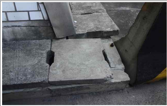
하행선 공동구 S83 덮개파손
