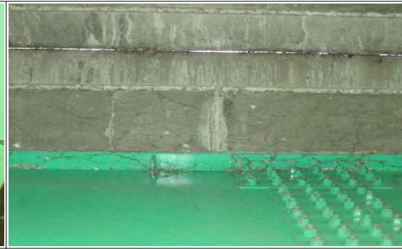
하행선 S10 바닥판 하면 캔틸레버부 균열부 백태
