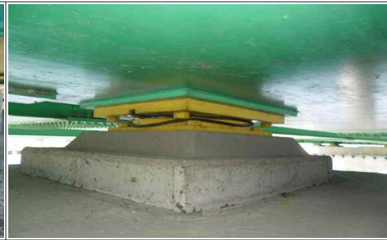
상행선 P4 SH4 Seal재 파손
