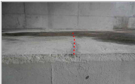
상행선 A2 상면 보수부 재균열 (폭0.2mm)
