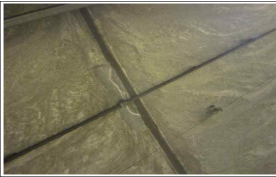
하행선 천정부 J72 콘크리트 들뜸 (A=0.1X0.2)
