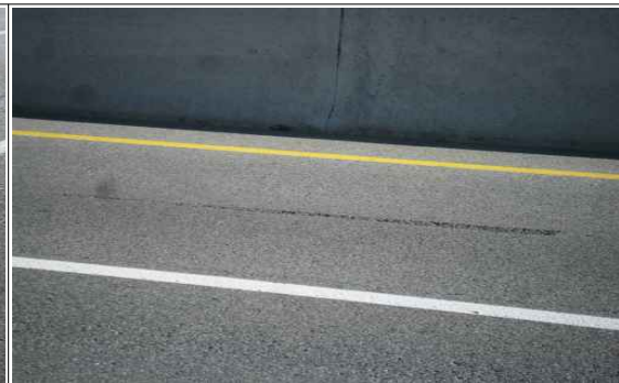
하행선 S5 교면포장 패임
