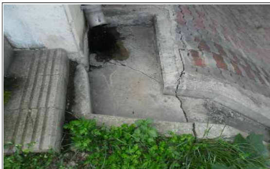
상행선 A1 배수로 균열 및 박리
