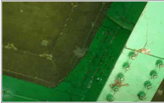
하행선 S6 바닥판 하면 콘크리트 파손
