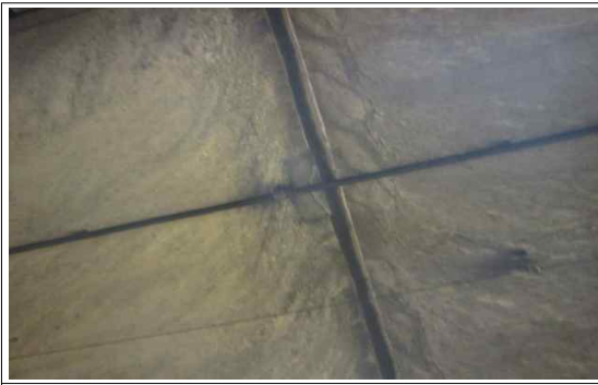
하행선 천정부 J71 콘크리트 들뜸 (A=0.1X0.2)
