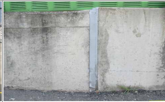
상행선 A2측 접속도로 구간 방호벽 단차 현황 및 실란트 파손 보수현황
