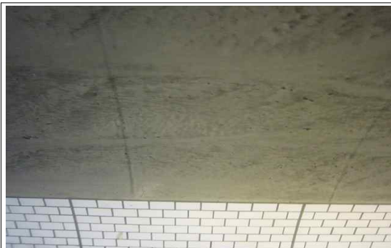
하행선 측벽부 S57 균열 (폭 0.3mm)
